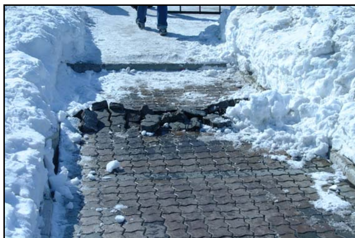
Рис. 3 Нарушение кладки пешеходной дорожки. (Фото С.Полуэктова )
