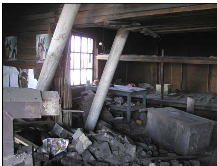
Рис.2 Переправа на р. Авьенваям. Разрушения внутри домика. (Фото Т.Пинегиной)
