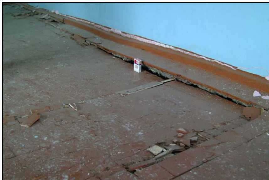
Рис.4 Нарушение поверхности пола в спортивном зале школы. (Фото С.Полуэктова)
